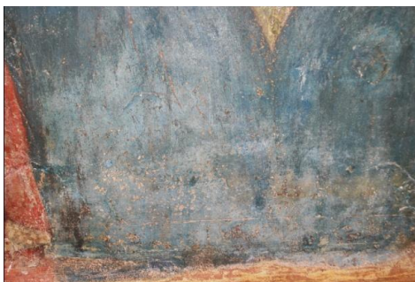
Foto 5. Efflorescenze saline nella parte bassa della Madonna.
